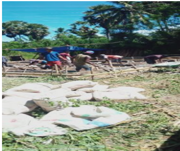
Gambar 5. Proses pembuatan fondasi rumah warga sebagai wujud nyata kerja sama yang mendukung ekonomi pada 7 Mei 2021
